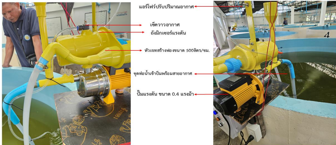
ภาพที่ 1 ลักษณะการติดตั้งระบบการเพิ่มอากาศด้วยเครื่องเพิ่มอากาศแบบไมโครบับเบิลขนาด 0.45 แรงม้า ที่อัตราการใช้ไฟฟ้า 300 วัตต์ต่อชั่วโมง
