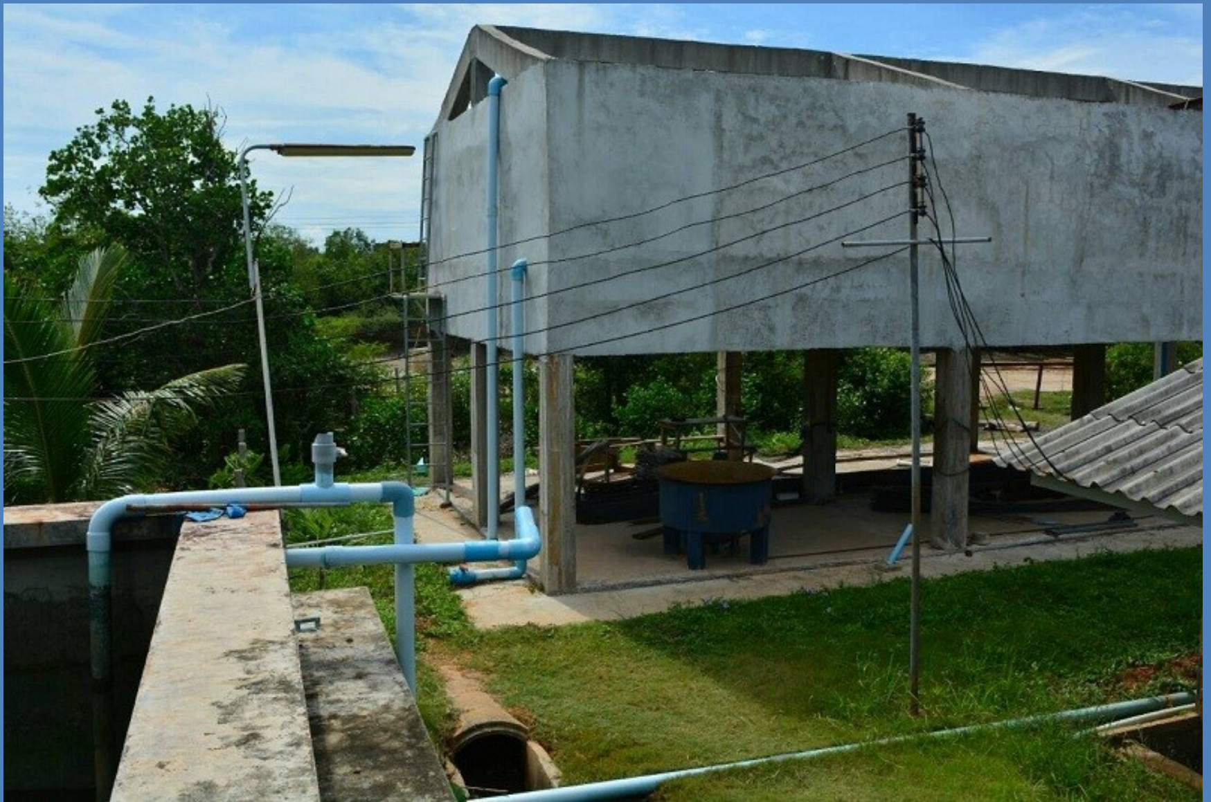
หอจ่ายน้ำ
