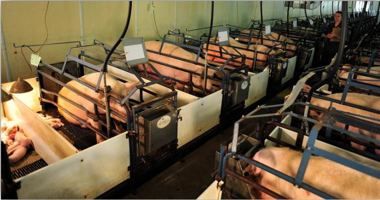
Cooling Pads แผ่นให้ความเย็นควบคุมด้วยระบบคอมพิวเตอร์ ติดตั้งในเล้าเพื่อให้ความเย็นแก่แม่พันธุ์สุกร
