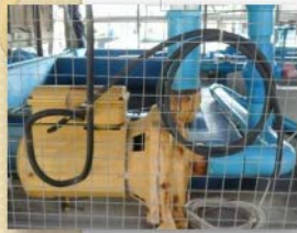
ปั๊มน้ำ สำหรับสูบน้ำจากระบบกรองและบำบัดน้ำ ไปยังถังเก็บน้ำ
