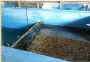
ระบบกรองและบำบัดน้ำ สำหรับกรองตะกอนและบำบัดน้ำให้มีคุณภาพดี
