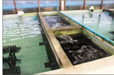
ภาพที่ 2 ระบบกรองชีวภาพในบ่อคอนกรีต
