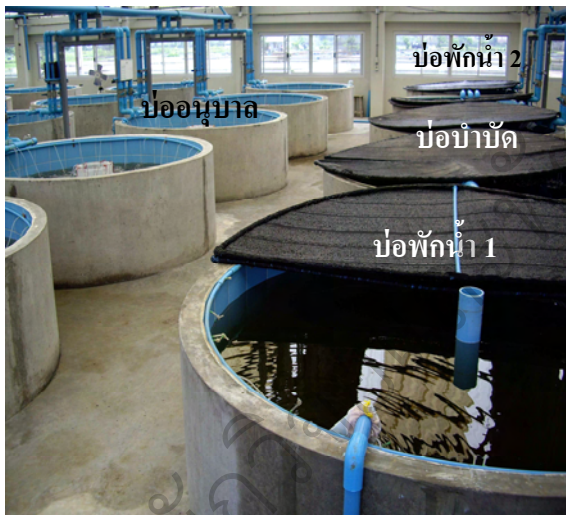
ภาพที่ 3 บ่ออนุบาล บ่อพักน้ำ และบ่อบำบัด
