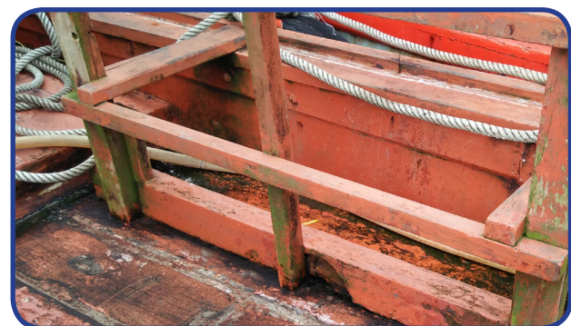
ไม่ผ่าน: ต่อเติมทำให้เกิดชอกมุม
