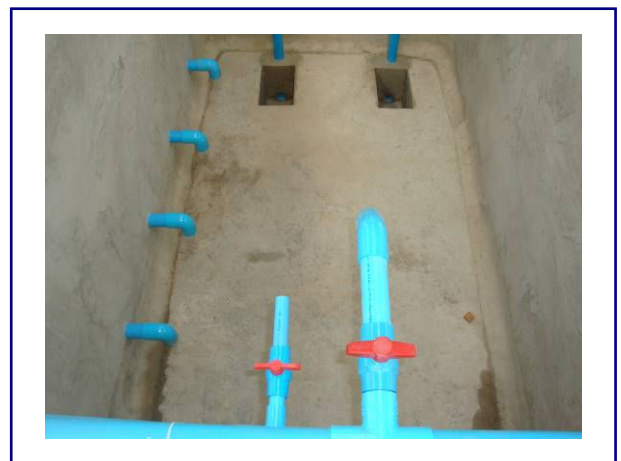
ท่อลดน้ำหมุนเวียน และปลายท่อน้ำ ลม
